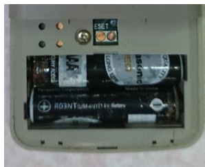
圖一 漏液的電池
